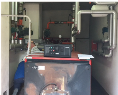
La vecchia caldaia a gasolio
