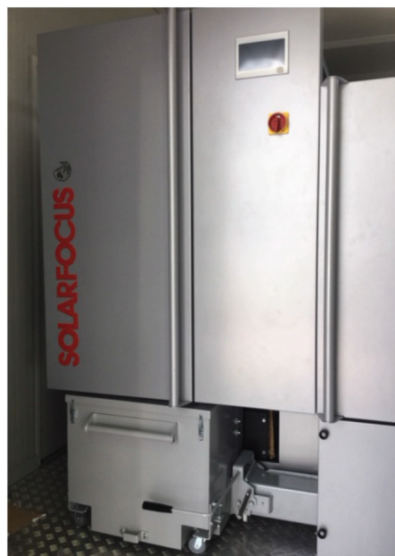
La caldaia Solarfocus Maximus da 300 kW
