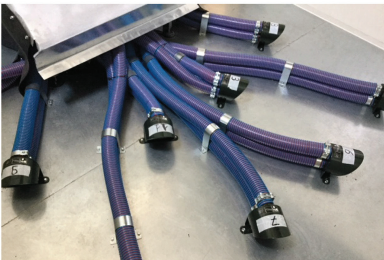
Le sonde di aspirazione del pellet all'interno del deposito
