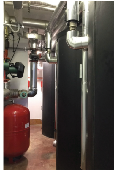
I puffer all'interno della stanza che ospitava la vecchia caldaia
